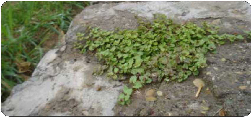
تصویر شماره ۵: رشد نهاجمی علفهای هرز از درز موزاییک و آسفالت
